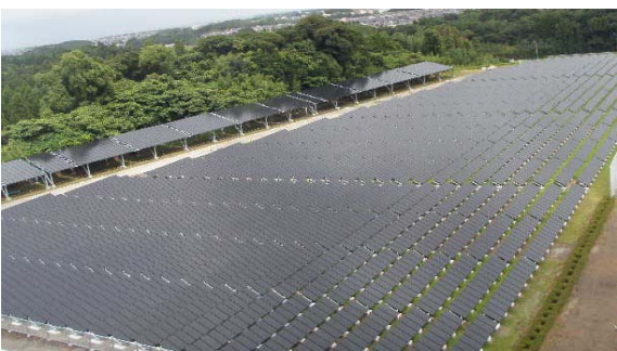
「宮崎ソーラーパーク」 宮崎メガソーラー（太陽光発電所） 発電規模： 1000キロワット（自家使用） 年間予想発電量： 約128万キロワット時 使用パネル枚数： 12,584枚
